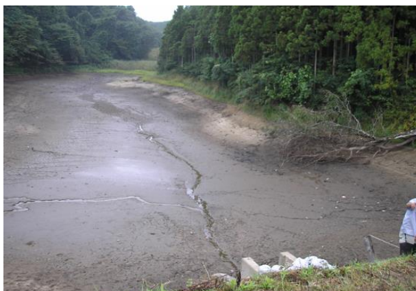
図11 堰堤の損傷で干出したため池
